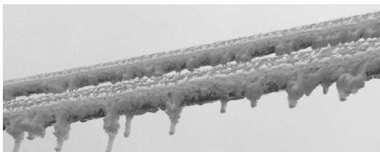
图10 四分裂导线上的冰凌情况
